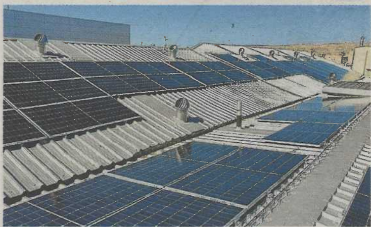
Placas solares instaladas en la residencia Rey Fernando. DFA
